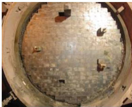
Figura 12 – Falha no preenchimento da massa refrataria
