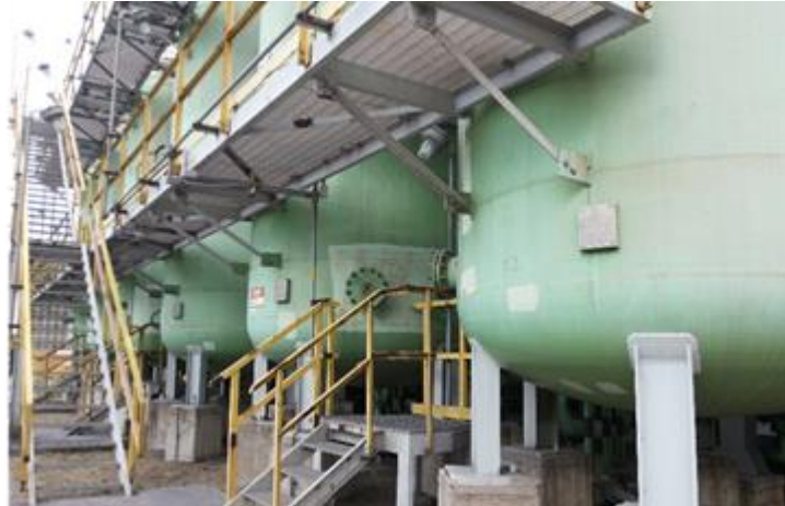
Figura 2. Filtros da MLC#02
