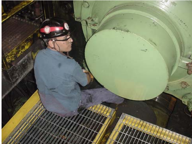
Figura 10. Passarelas de apoio para conexão e desconexão de mangueiras de lubrificação dos Morgoil®, além de agilizarem as operações, representaram maior segurança aos operadores.
