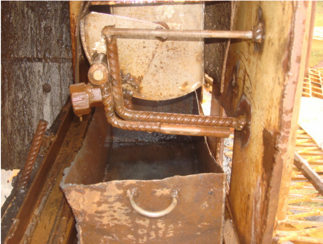
Figura 20 - linha de ar comprimido
