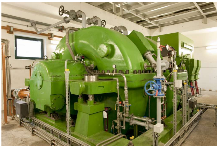
Fig. 12: TRT at ThyssenKrupp Steel, Duisburg, Hamborn, BF8.
