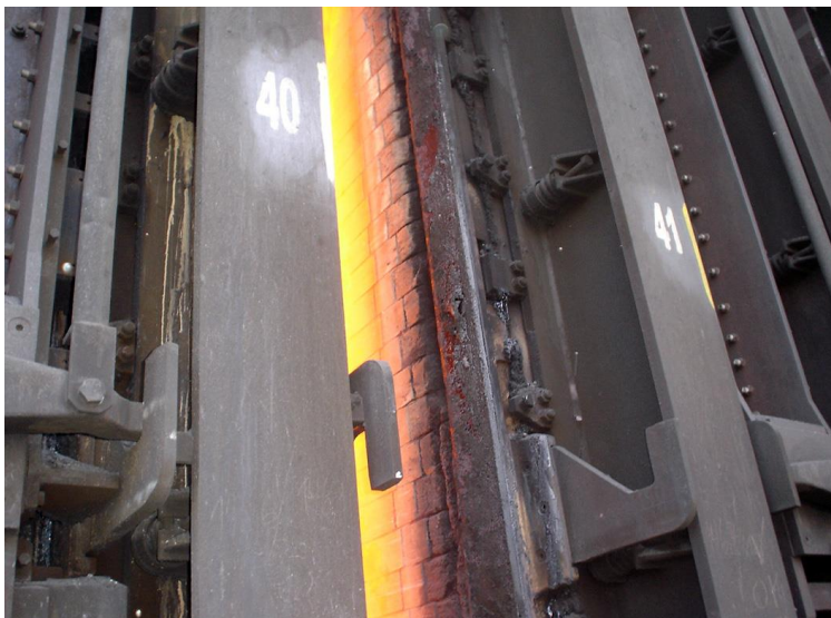
Figura 2. Trincas e desgaste no jamb joint .
