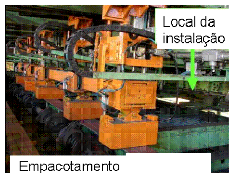
Figura 11 – Empacotamento existente com cabeçote magnético.
