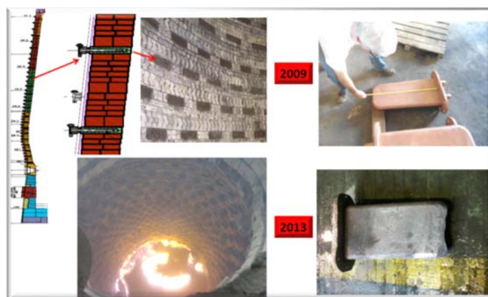
Figura 11– 100% das placas queimam em sua extremidade
