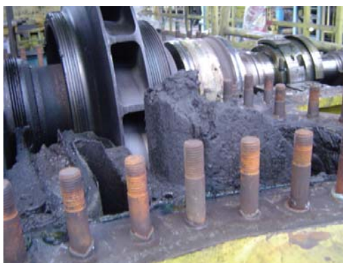
Figura 2 – Excesso de Sólidos encontrados no rotor do Booster.
