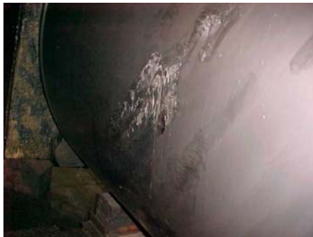
Figura 5: Cilindros de encosto da cadeira #1 com incrustação de material transferida pelo cilindro de trabalho.
