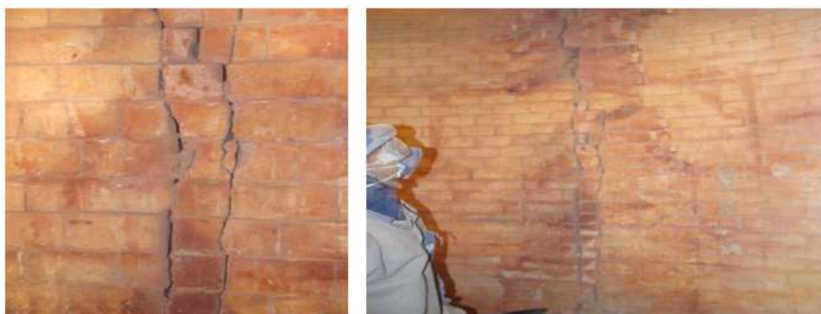
Figura 12 – Parede divisória, trincas verticais.
