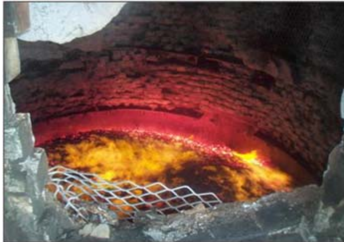
Figura 2. Evidência da chaparia exposta através da inspeção realizada em 27/08/2012 durante a atividade de manutenção do cone.
