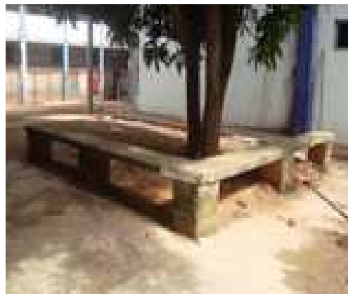
Figura 3. Foto do banco deteriorado
