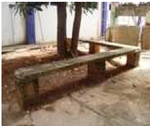
Figura 2 Foto do banco deteriorado
