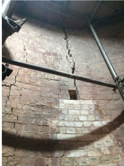
Figura 12. “Curto circuito” na parede divisória entre a câmara de combustão e o empilhamento de tijolos.
