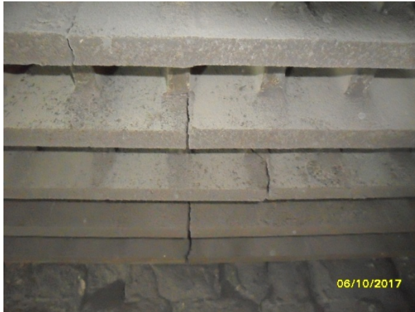
Figura 13.Trincas nas grelhas de sustentação.
