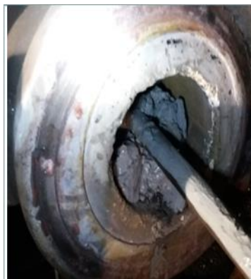
Figura 9. Observação de material refratário na região entre ventaneiras 19 e 24.
