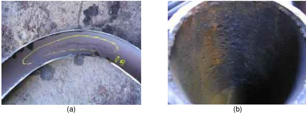
Figura 8. Marcas longitudinais sobre a superfície de óxido e pites grandes e profundos.
