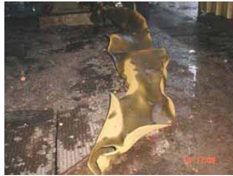
Figura 5. Vista geral do tubo que rompeu do lado direito da caldeira.
