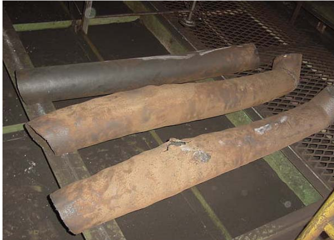
Figura 4 Trecho da serpentina danificada devido à cargas térmicas
