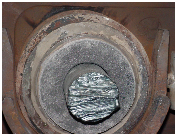
Figura 1 – Vista de baixo da válvula inferior do distribuidor com obstrução de aço
