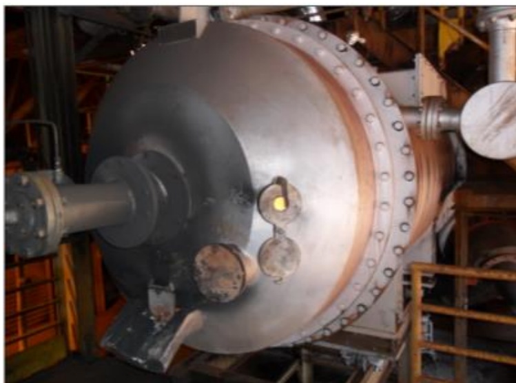
Figura 6: Câmara compacta industrial instalada na usina Sul de secagem e moagem
