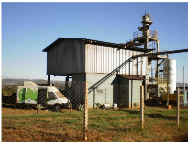
Figura 3. Planta piloto de combustão na VMN Niquelândia junto ao veículo de monitoramento on-line de emissões do IPT
