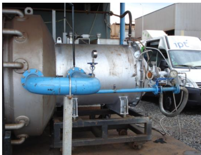
Figura 4: Câmara Compacta instalada na Planta Piloto
