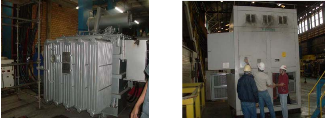
Figura 1. Fotos de ocorrência de queima de transformadores.
