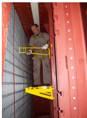
Figura 7. Plataforma de manutenção.
