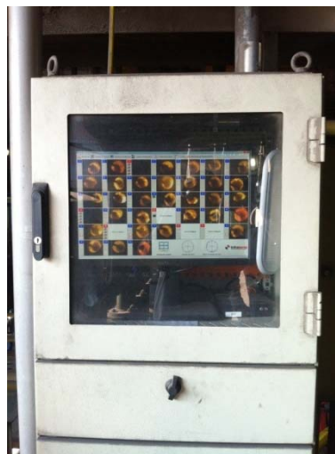
Figura 8 – Painel do sistema de monitoração das ventaneiras na Sala de Corridas
