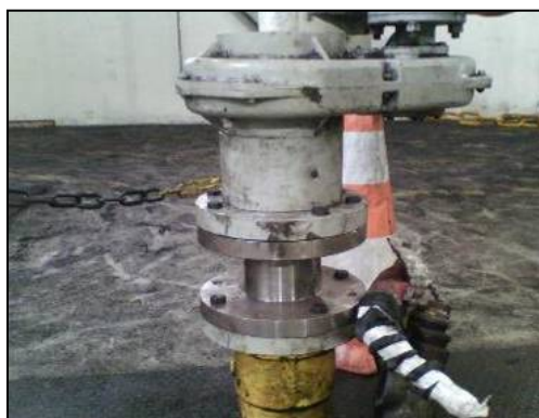
Figura 17. Carretel e atuador montados na válvula Fonte: ArcelorMittal Tubarão (2013).
