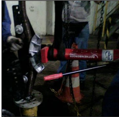
Figura 6. Desempeno parcial da haste utilizando equipamento específico de dobramento de tubos Fonte: ArcelorMittal Tubarão (2013).
