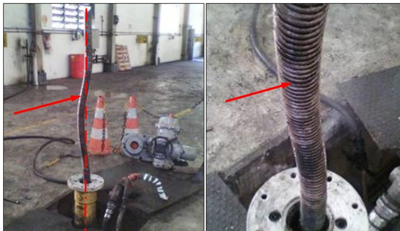
Figura 5. Haste de acionamento empenada, impedindo o acionamento automático da válvula Fonte: ArcelorMittal Tubarão (2013).
