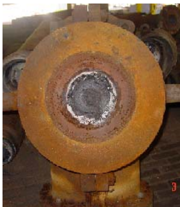
Figura 13 – Junta de expansão obstruída.
