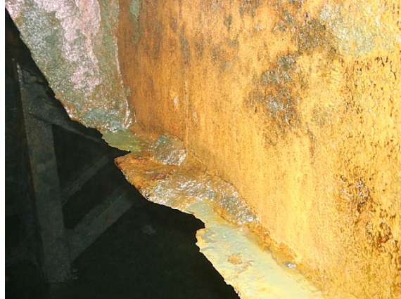
Figura 8. Estado das chapas do anel de sustentação do concreto
