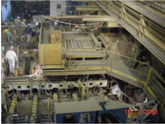
Foto 1 – Mesa para cambio de barra falsa
