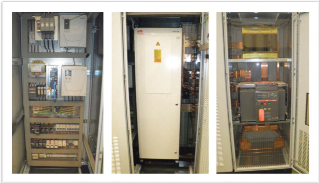
Figura 8. Acionamento Novo do Bloco Acabador
