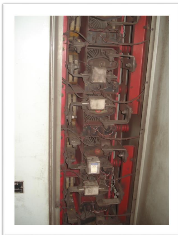
Figura 7. Tiristores do Acionamento Obsoleto do Bloco Acabador
