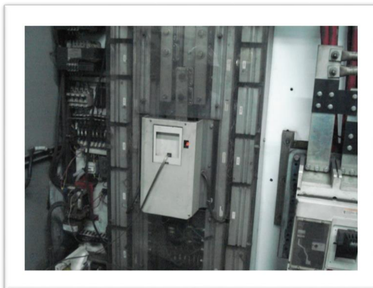
Figura 6. Acionamento Obsoleto do Bloco Acabador
