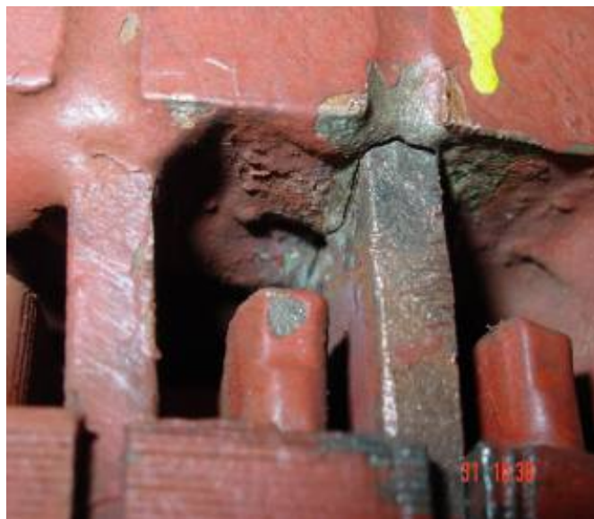
Figura 9 – Fotografia das barras quebradas.
