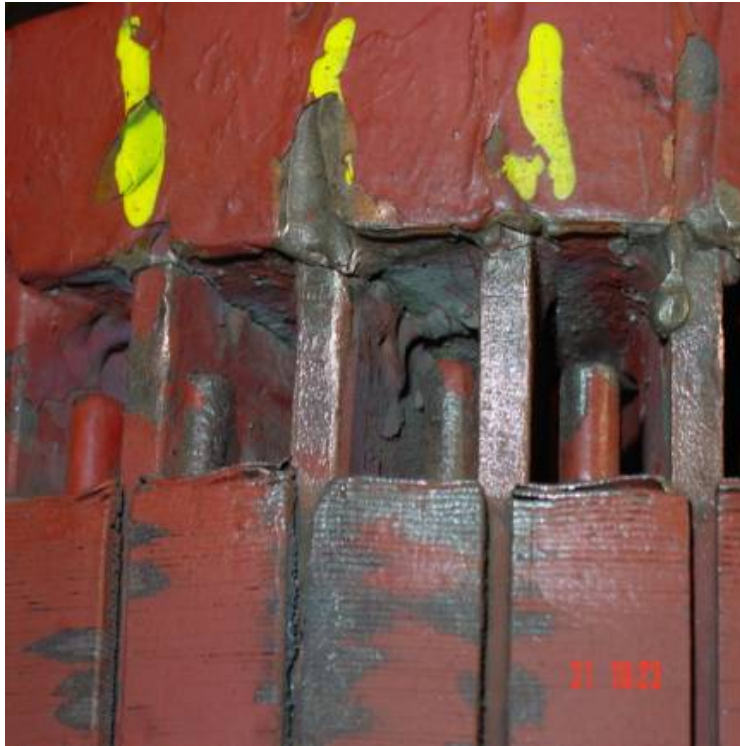
Figura 10 – Fotografia das barras quebradas.
