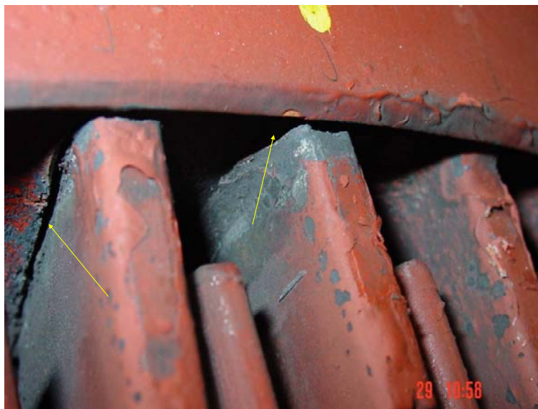
Figura 6 – Fotografia das barras quebradas.
