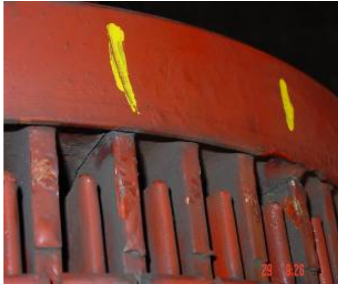
Figura 5 – Fotografia das barras quebradas.
