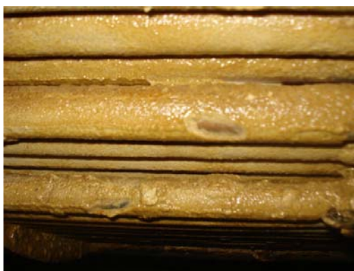
Figura 5: Impregnação de lama e sais nos tubos do trocador em 2008.
