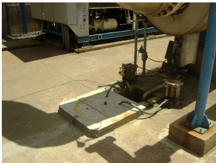
Figura 8: Captação definitiva de água condensada do trocador E07.
