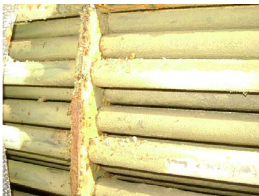
Figura 6: Impregnação de lama e sais nos tubos do trocador em 2011.
