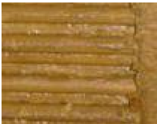
Figura 4: Impregnação de lama e sais nos tubos do trocador em 2005.
