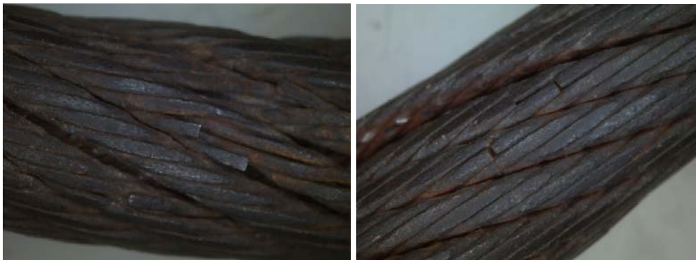
Figura 1. Trincas secundárias encontradas nos cabos. As imagens também mostram planos superficiais retos nos fios periféricos, o que indica desgaste.
