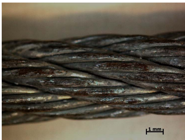
Figura 3: Cabo fraturado com planos de desgaste nos fios a 2 metros da região de falha.
