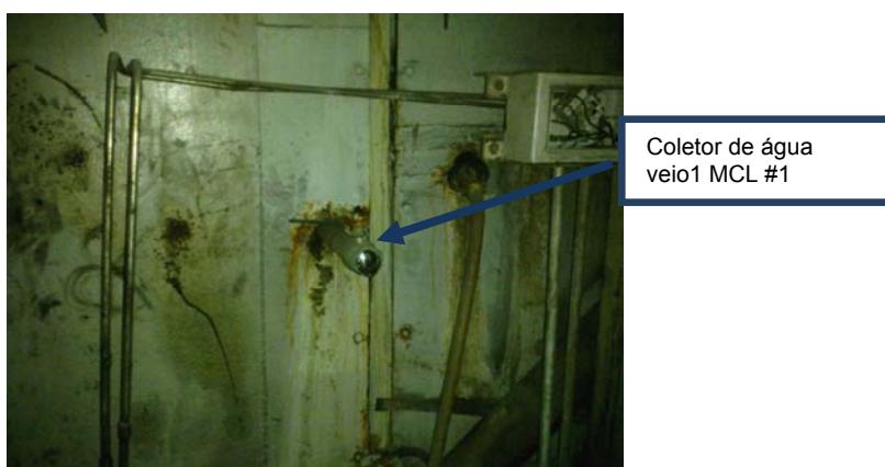
Figura 3. Coletor de água do veio 1 da MCL #1.
