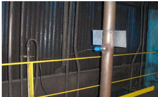
Figura 10. Flowjam S instalado na linha principal de injeção do AF#2.
