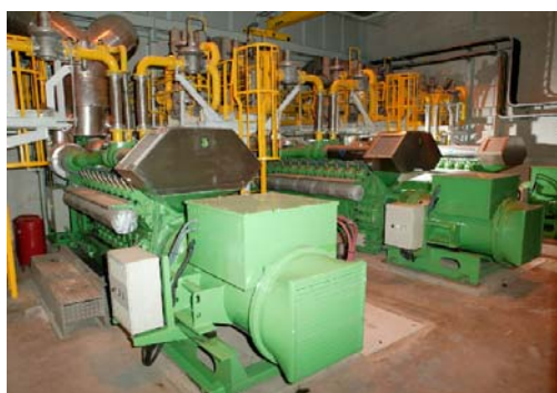
Figura 9: Vista de 3 dos 12 motores.
