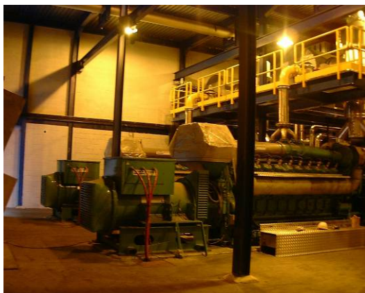
Figura 3: Motores a gás de coqueria 2 x J620GS.
