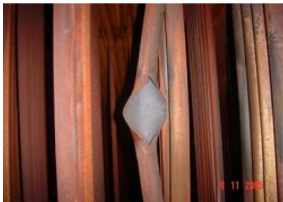
Figura 2. Falha do tubo da caldeira.
