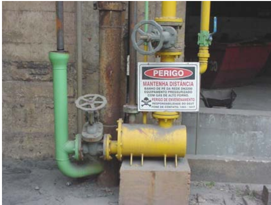
Figura 11 Banhos-de-pé, de tamanho. reduzido e tubulação de água de 1”.
