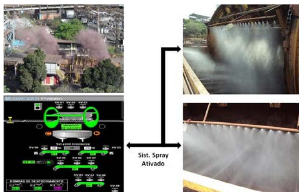
Figura 26 – Sistema de Despoeiramento do VV com spray ativado.
