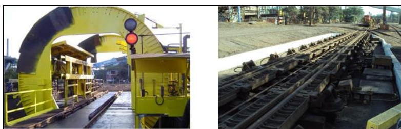
Figura 2 – Virador de Vagões de Minério e Retardador de Vagões.
