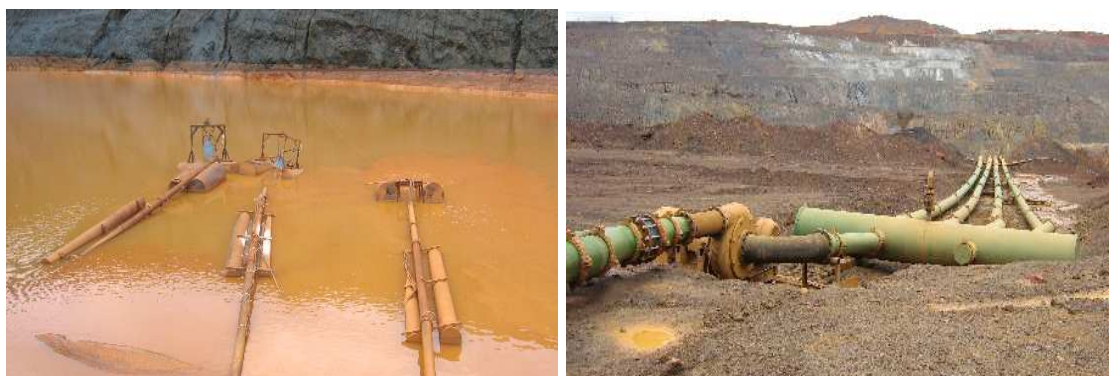
Figura 4. Sistema de bombeamento.
