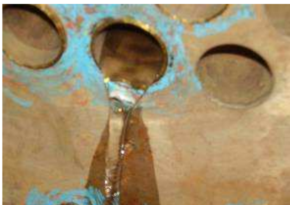
Figura 13 - Identificação de Furo Condensador de Superfície (8)
