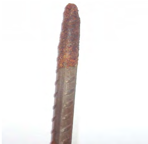
Figura 4. Parte da armadura onde houve maior intensidade de corrosão.
