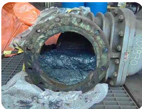
Figura 2. Resíduo formado na rede de GCO, próximo a Sinterização 4, 02.06.2011.
