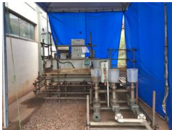
Figura 8. Equipamento para execução de teste piloto/industrial.
