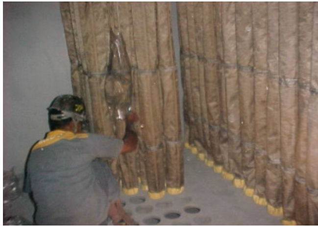
Figura 5 - Troca das Mangas dos Filtros de Mangas da Calcinação
