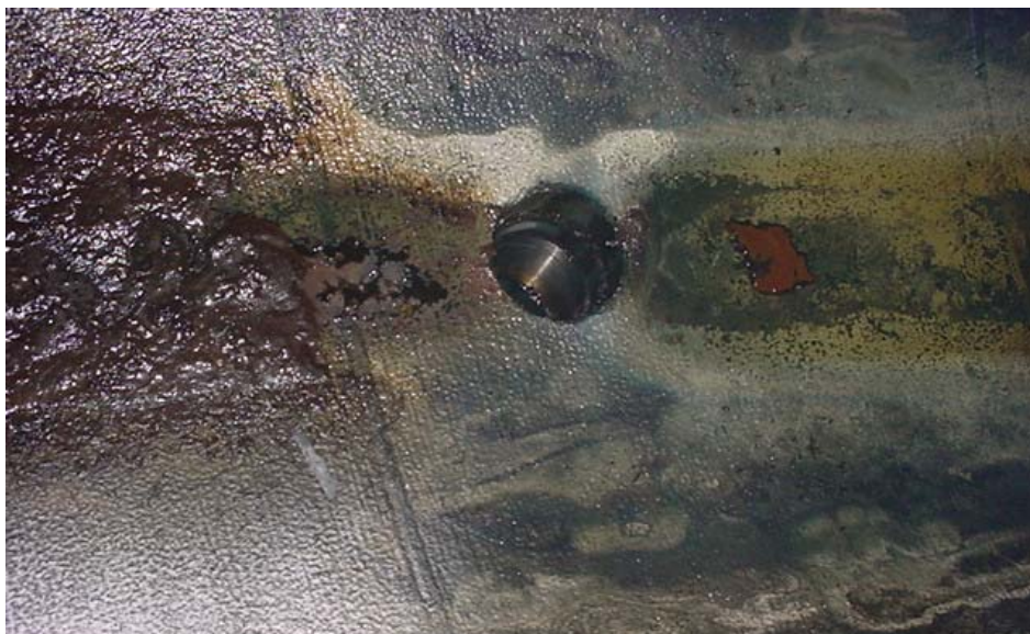
Figura 11: Ponto de descida do condensado para o dreno
