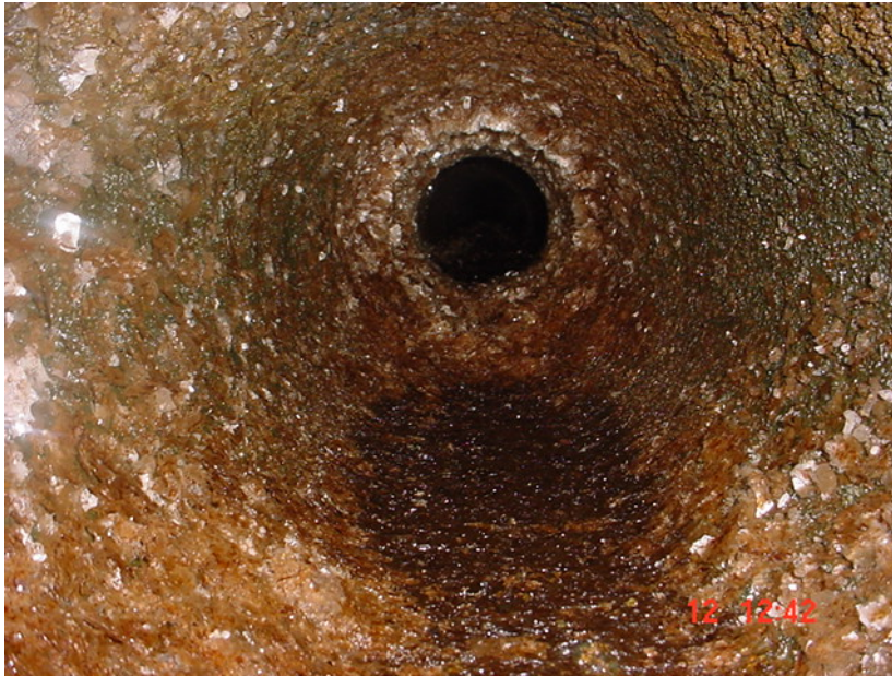
Figura 9: rede de 12" da Sinterização 2 após dois anos sem limpeza interna.(ponto baixo)
