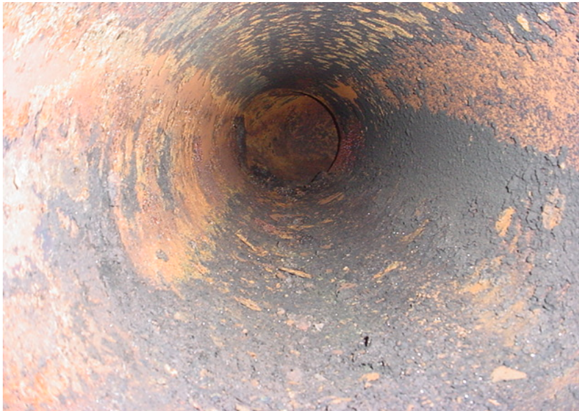
Figura 10: rede de 12" da Sinterização 3 Trecho com um ano e dois meses sem limpeza.(ponto alto)
