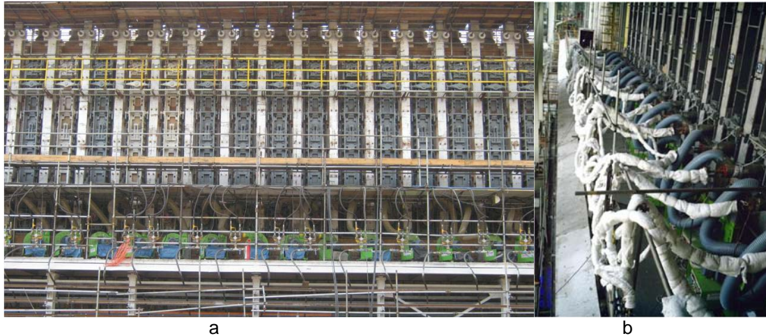
Figura 4 – Detalhes dos canhões de injeção de gás quente. a) Ventiladores posicionados abaixo da plataforma de serviço. b) Detalhe do canhão posicionado no orifício da porta do forno.
