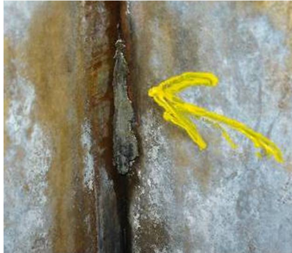
Figura 1 – Infiltração de aço entre as placas de cobre do molde da MLC#2.
