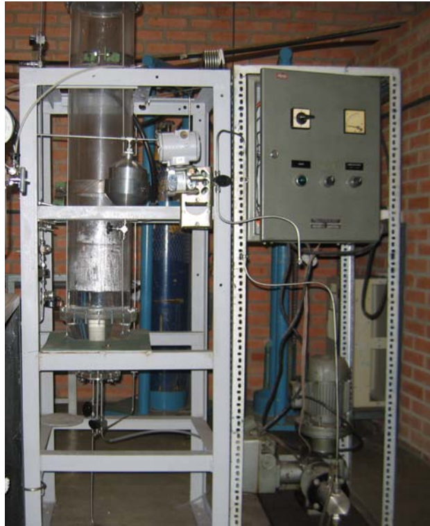
Figura 6. Detalhe da estação de controle e tratamento da água
