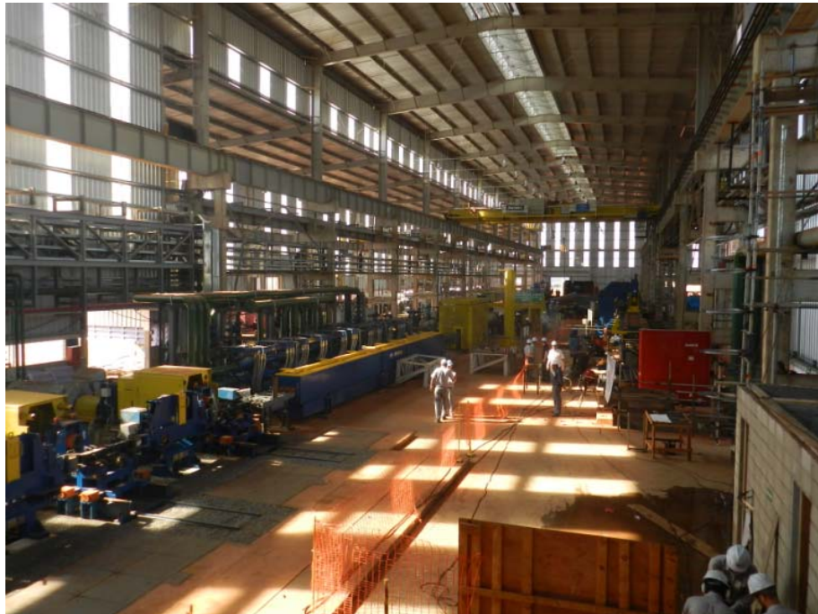
Figura 4. Laminador acabador, tratamento térmico e tesoura fracionadora.
