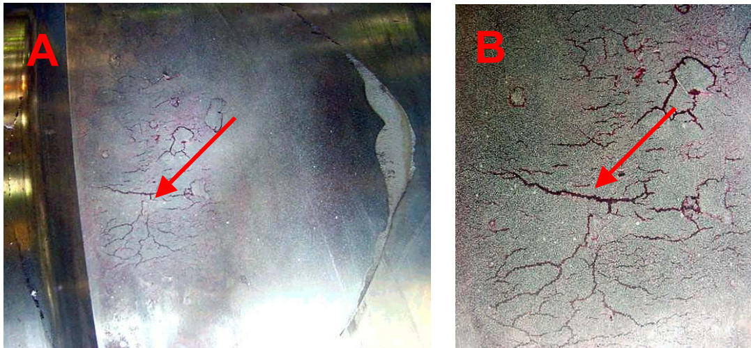
Figura 10 (a) Mesmo defeito da Figura 9, existente na região da trinca semi- circunferencial; (b) Detalhamento da trinca longitudinal indicada pelas setas, circundada por malha de trinca por tensão térmica.
