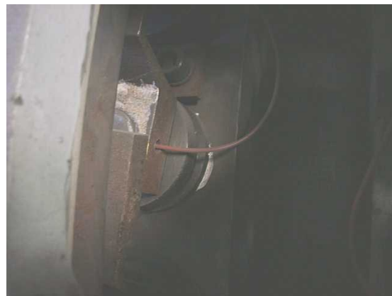
Figura 18 – detalhe do cabo passando pelo pino de fixação da palheta
