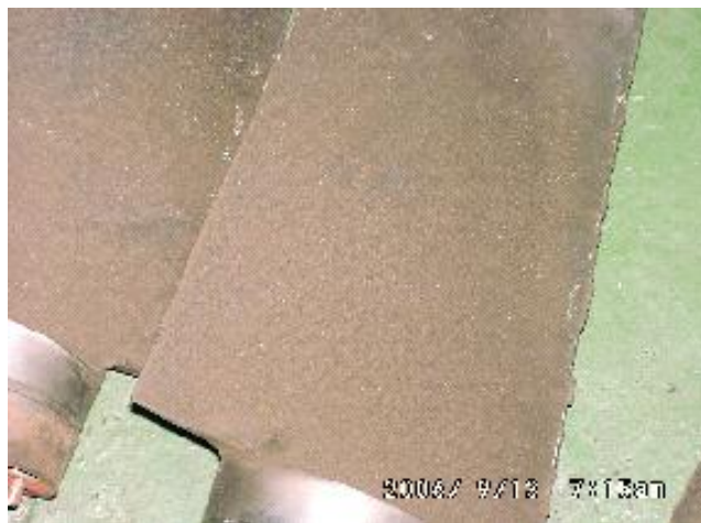
Figura 6 – Acúmulo de pó nas palhetas da IGV
