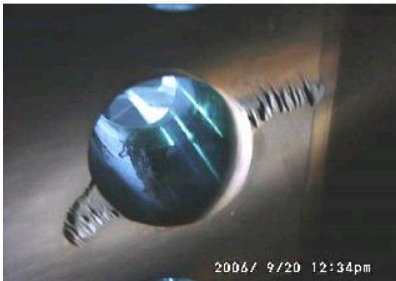
Figura 14 – carcaça do soprador danificada pelo contato com as palhetas
