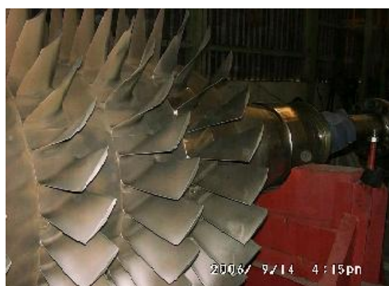
Figura 8 – Rotor antes da limpeza
